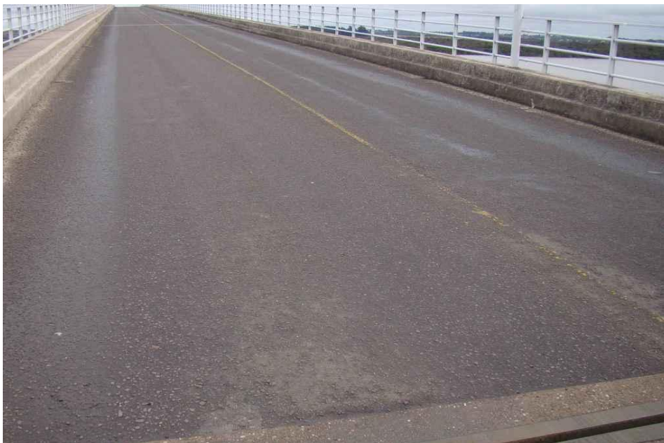
Figura 37. Defectos en la señalización horizontal.
