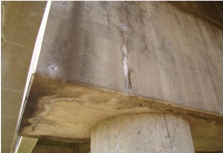
Figura 16. Vista del dintel de la Pila 1 (Lado Uruguayo). Se observan fisuras y manchas de exudación.
