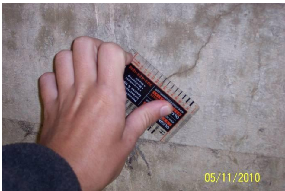
Figura 19. Detalle de una de las fisuras en el Estribo 1 (Lado Uruguayo).
