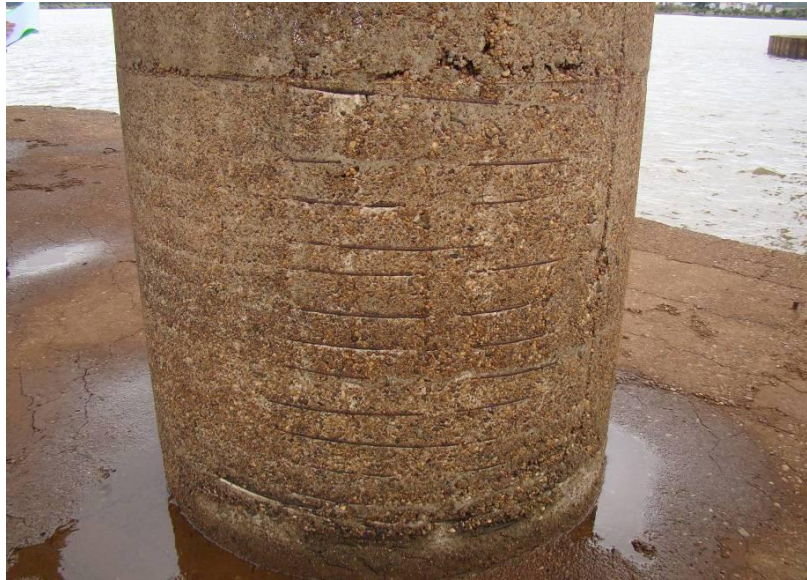
Figura 15. Vista de la Columna 1 de la Pila 16. Se observa un sector de la columna con peladura y con armadura de refuerzo transversal expuesta.
