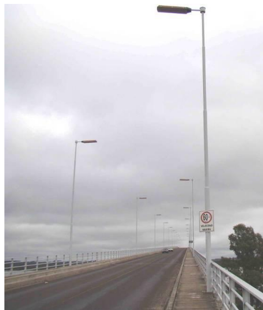
Figura 41. Columnas de alumbrado en buen estado.
