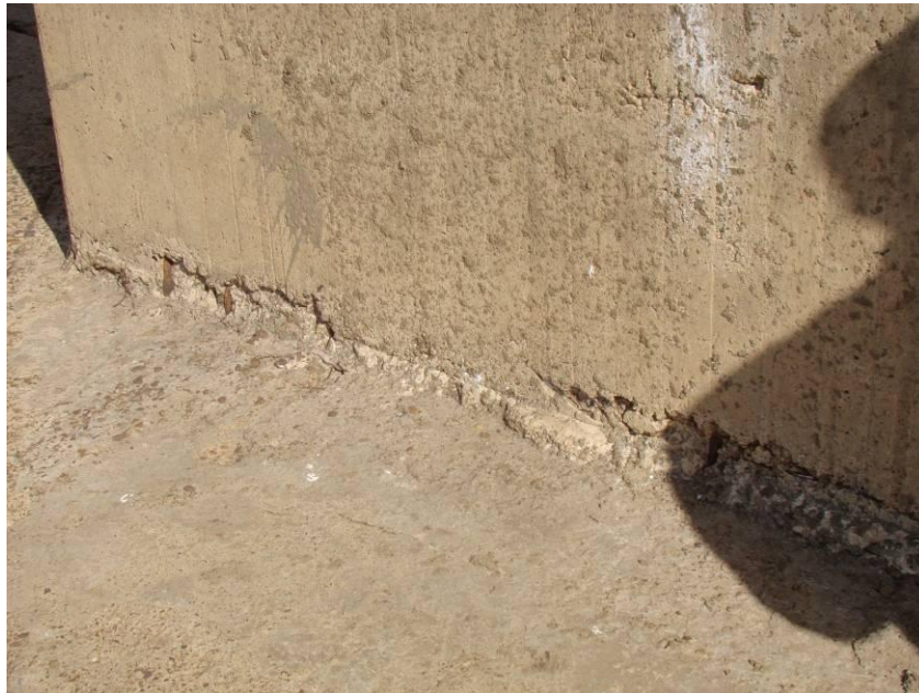
Figura 18. Detalle de la falta de recubrimiento en el extremo inferior de la Pila 11.
