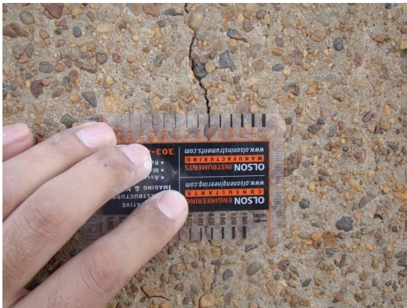
Figura 17. Detalle de una de las fisuras relevadas en la Pila 10 (Puente Principal).
