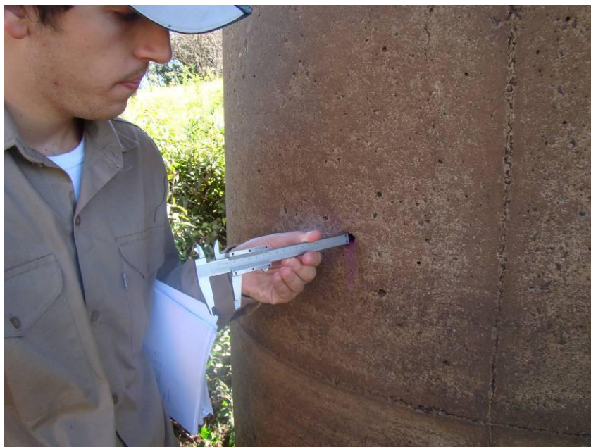
Figura 27. Medición de la profundidad de carbonatación en la Pila 40.
