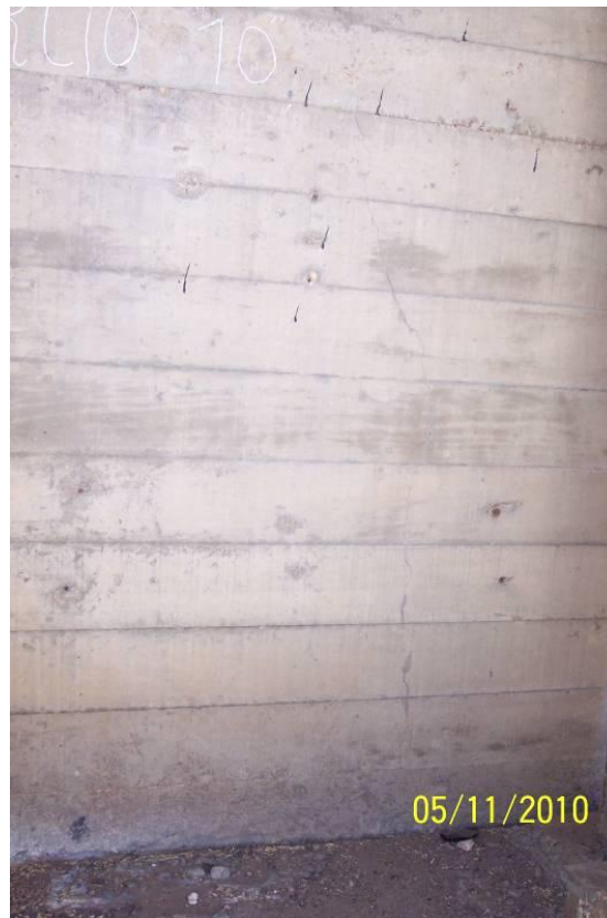
Figura 20. Detalle de Fisura en Estribo 2 (Lado Argentino).
