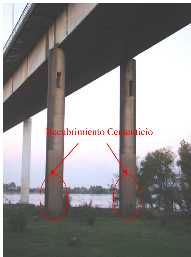
Figura 24. Vista de la Pila 21 (Viaducto Argentino). Se encuentra indicada la reparación con recubrimiento cementicio.
