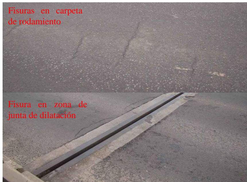
Figura 36. Defectos en carpeta de rodamiento.
