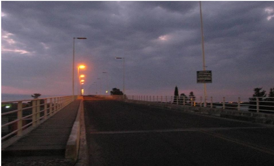
Figura 42. Vista del estado de la iluminación sobre el tablero, el 70 % de las luminarias se observan apagadas.
