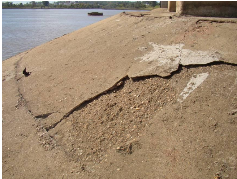
Figura 23. Pérdida de recubrimiento en cabezal de Pila 12.
