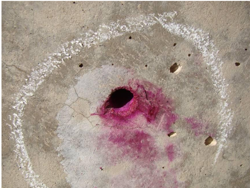
Figura 26. Ensayo de Carbonatación en la Columna 1 de la Pila 2. Se observa que no se presenta carbonatación en la estructura.
