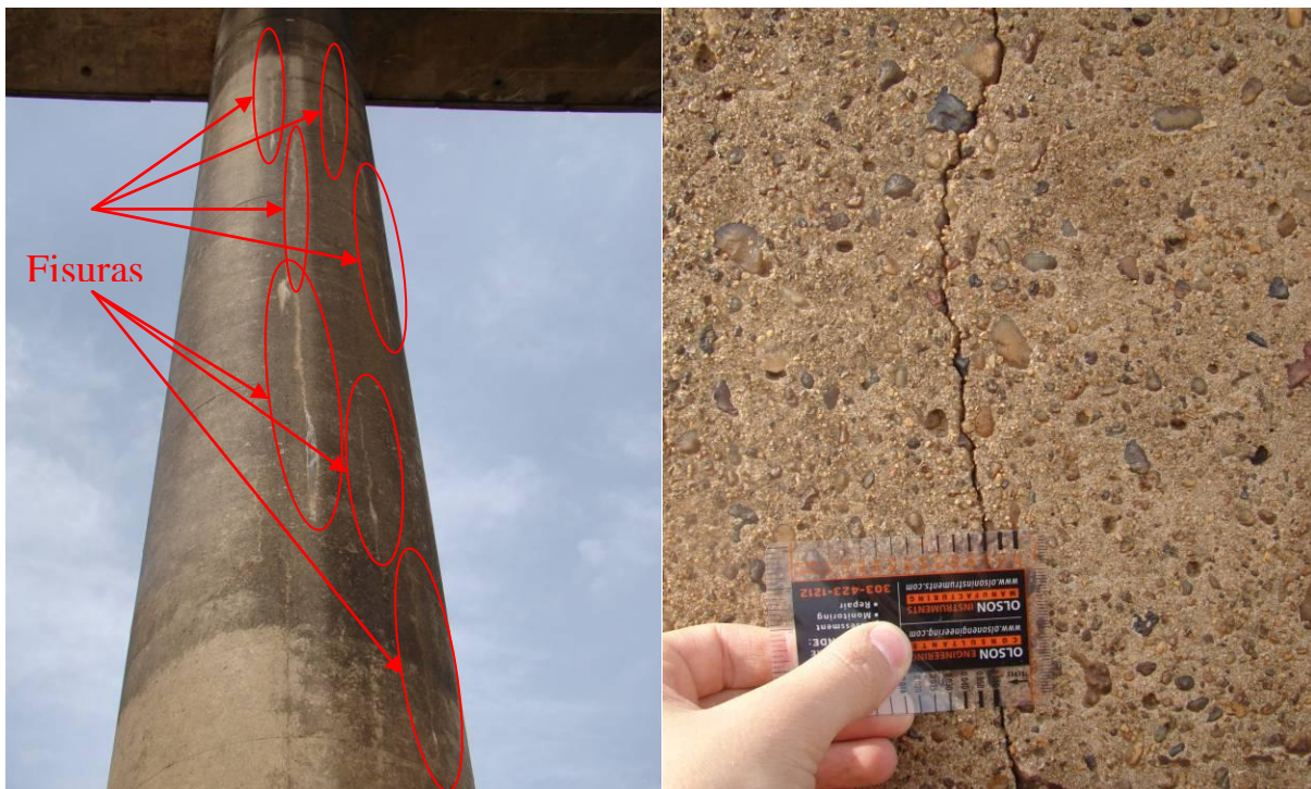
Figura 14. Vista de la Columna 1 de la Pila 19 (Lado Argentino). A la izquierda de la figura se encuentran indicadas las fisuras, a la derecha se observa una imagen de la medición del espesor de la fisura.
