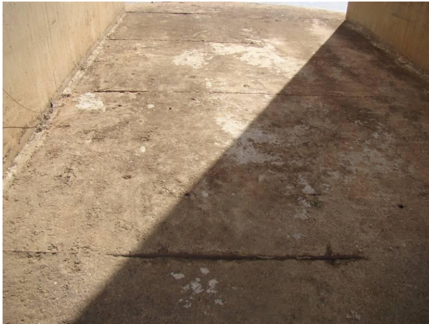
Figura 21. Vista de la armadura expuesta en el cabezal de la Pila 11.
