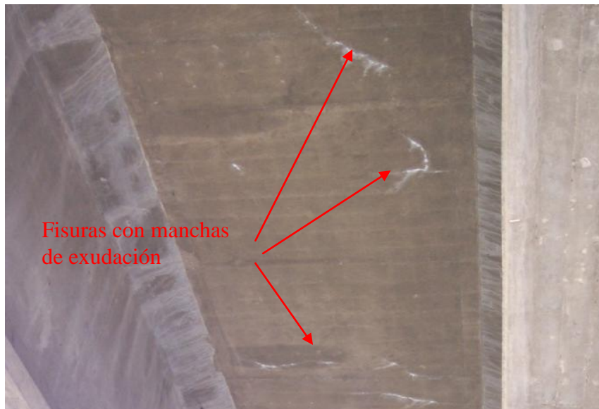
Figura 31. Detalle de fisuras con manchas de exudación de color blanco en la cara inferior de la losa (tramo 2).
