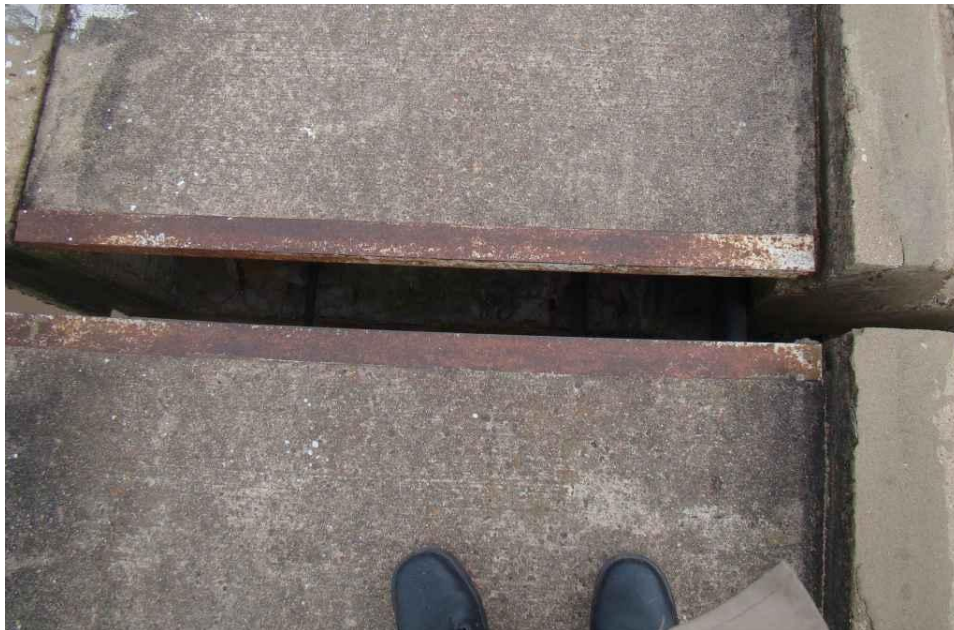
Figura 39. Dispositivos de juntas de dilatación en veredas. Oxidación de los perfiles metálicos.
