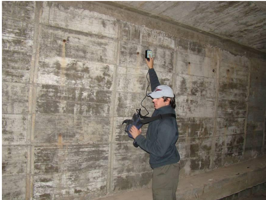
Figura 33. Ensayo para determinar el recubrimiento (Pachómetro) en interior de la viga cajón (Tramo 11).
