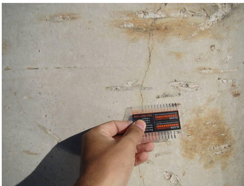
Figura 11. Vista de una fisura en la Columna 2 de la Pila 38.
