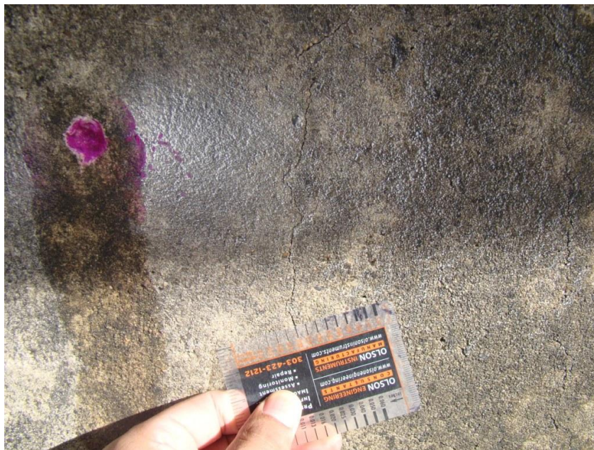
Figura 22. Fisura en Viga Ménsula del Cabezal de la Pila 5.
