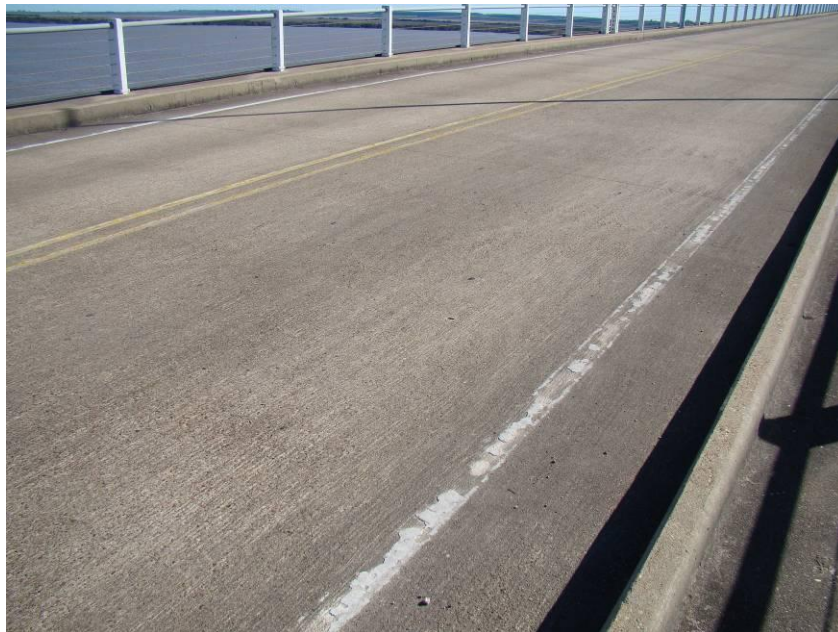
Figura 28. Defectos en la señalización horizontal.
