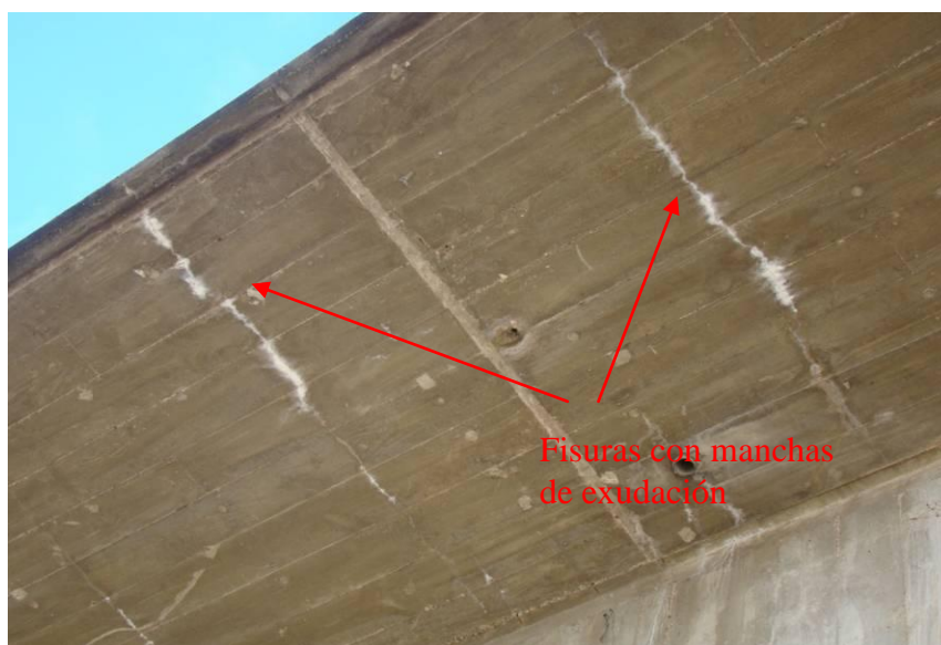
Figura 23. Detalle de fisuras con manchas de exudación en cara inferior de la losa en el tramo 10.
