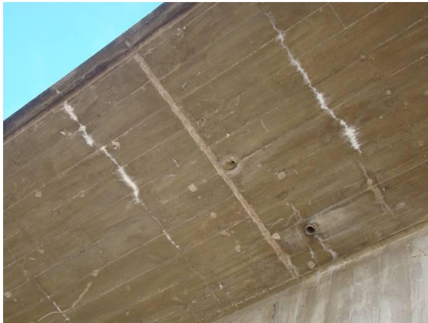
Figura 32. Vista cara inferior de vereda peatonal, se observan fisuras con manchas de exudación de color blanco.
