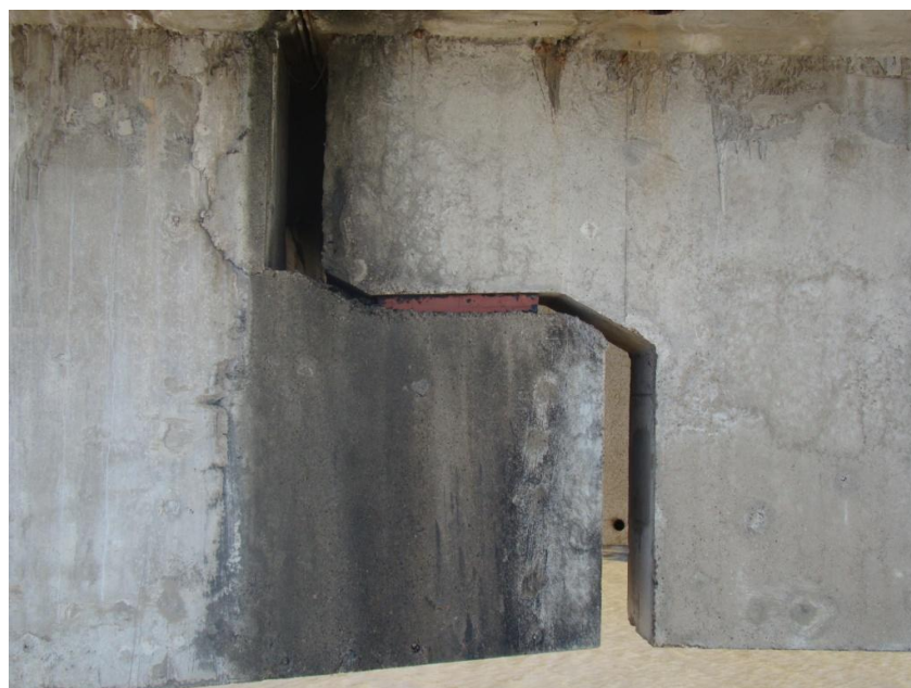
Figura 24. Vista de los dispositivos de apoyo en las ménsulas de apoyo de los tramos isostáticos.
