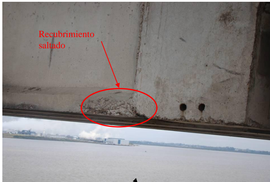
Figura 20. Detalle de recubrimiento saltado en viga 4 del tamo 20.
