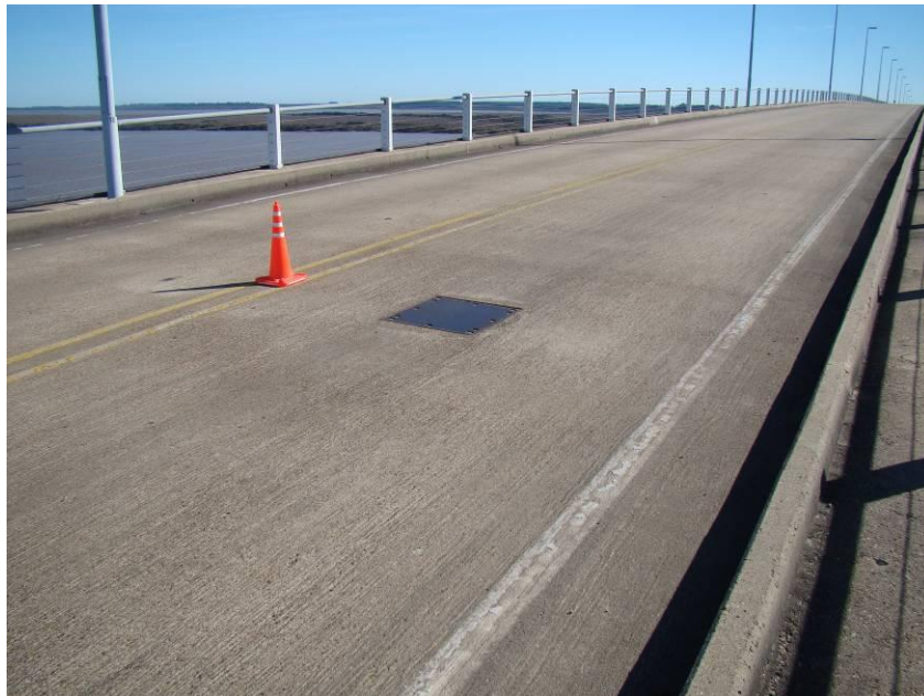
Figura 27. Estado de la carpeta de rodamiento.
