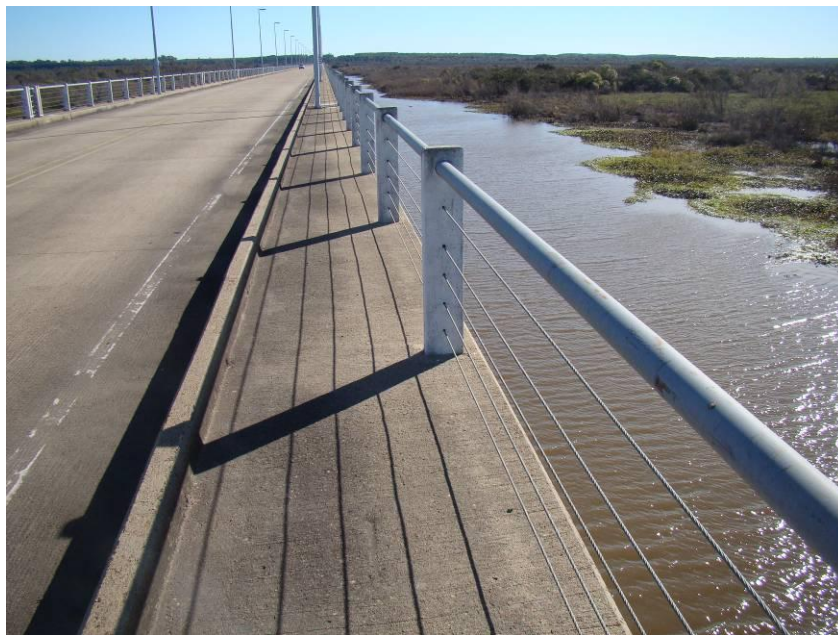
Figura 31. Vista cara superior de vereda peatonal y baranda metálica en buen estado.
