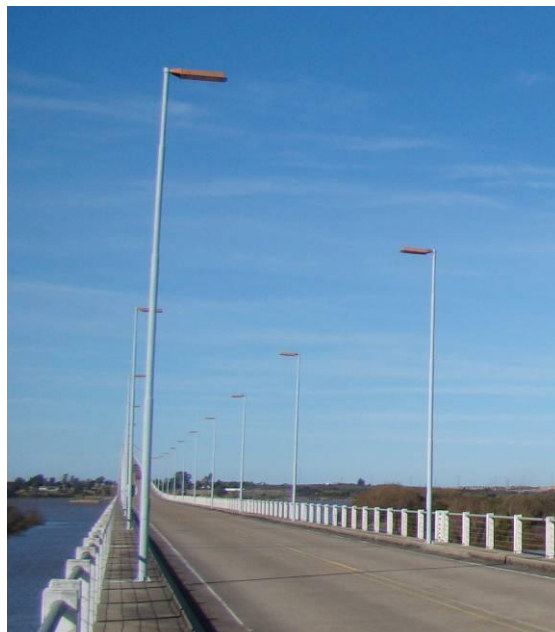
Figura 33. Columnas de alumbrado en buen estado.
