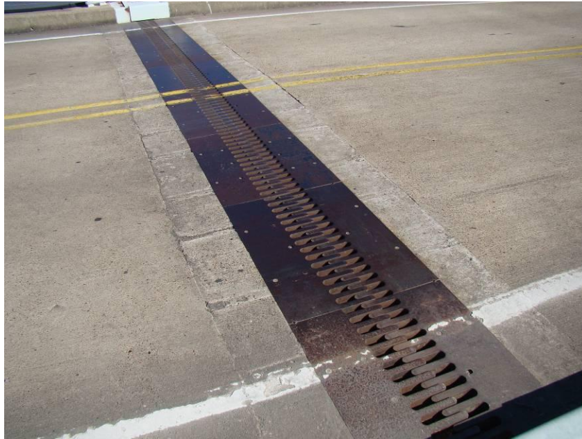
Figura 30. Dispositivo de junta de puente principal.
