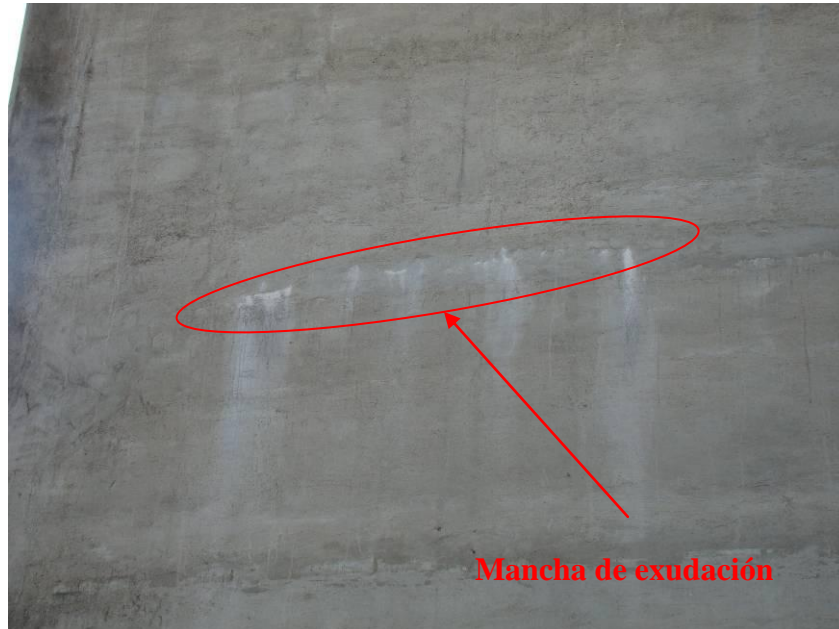
Figura 12. Mancha de exudación en fisura horizontal sobre la cara del lado Argentino de la Pila 2.
