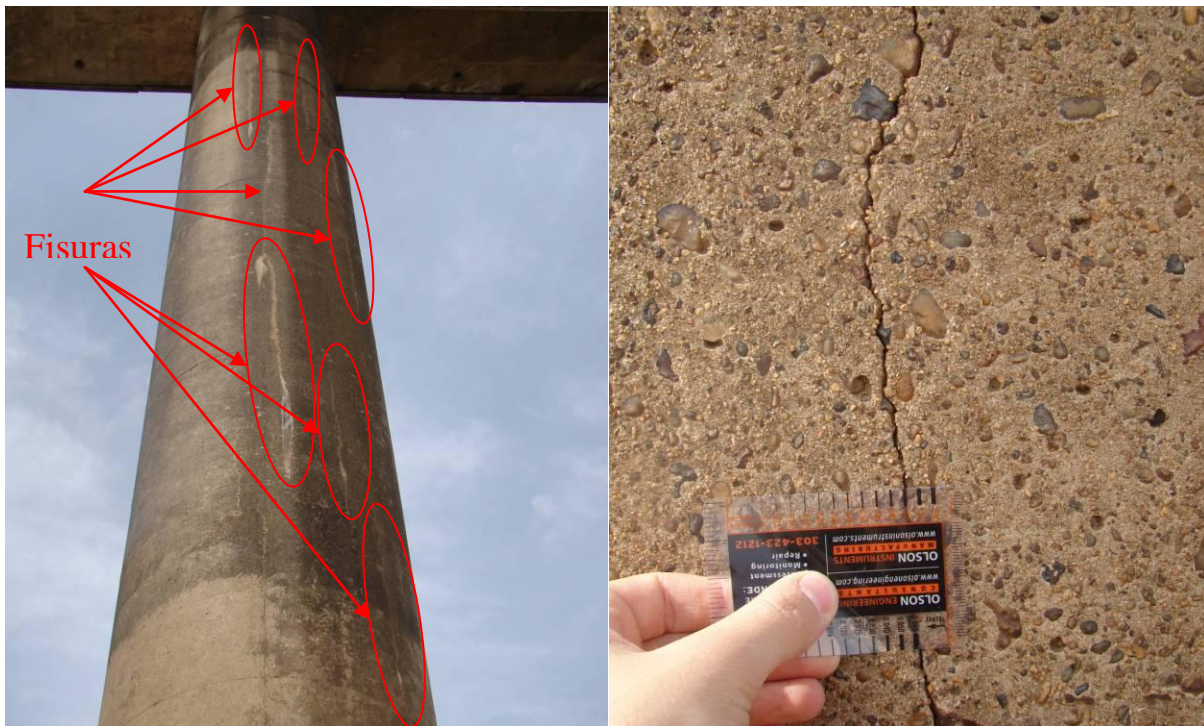
Figura 2. Vista de la Columna 1 de la Pila 19 (Lado Argentino). A la izquierda de la figura se encuentran indicadas las fisuras, a la derecha se observa una imagen de la medición del espesor de la fisura.
