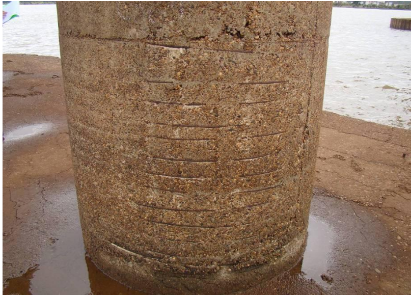
Figura 3. Vista de la Columna 1 de la Pila 16. Se observa un sector de la columna con peladura y con armadura de refuerzo transversal expuesta.
