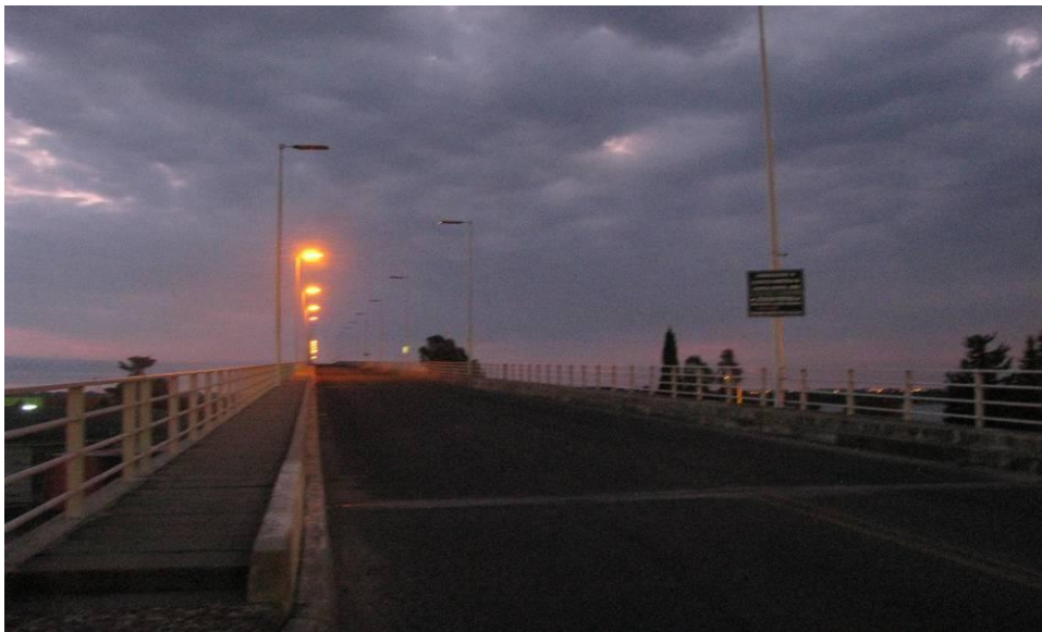
Figura 17. Vista del estado de la iluminación sobre el tablero, el 70 % de las luminarias se observan apagadas.
