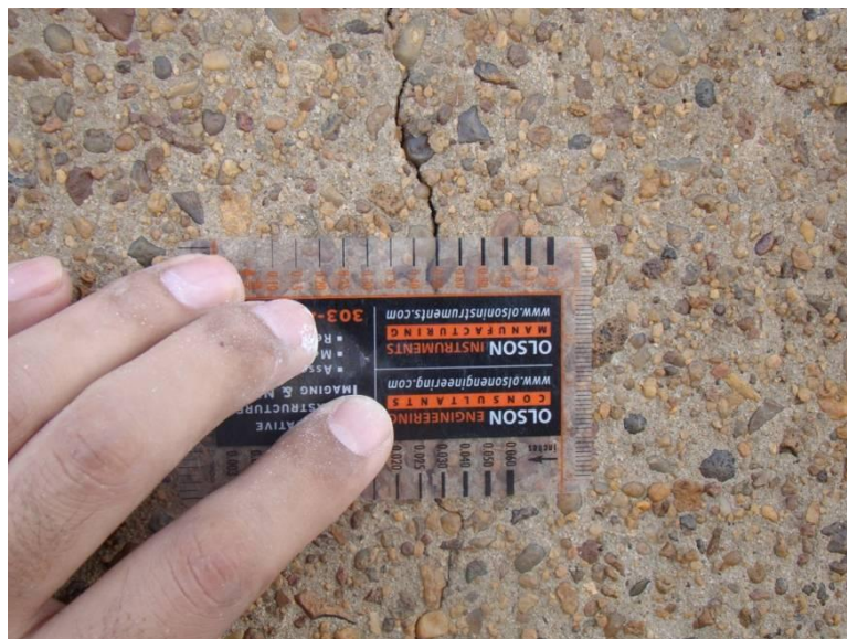
Figura 4. Detalle de una de las fisuras relevadas en la Pila 10 (Puente Principal).
