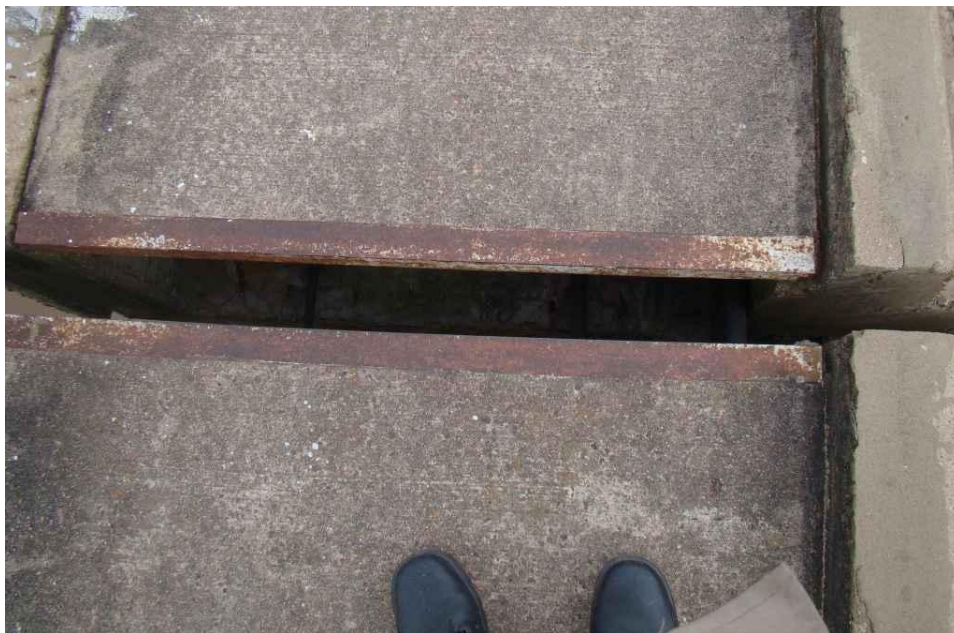
Figura 16. Dispositivos de juntas de dilatación en veredas. Oxidación de los perfiles metálicos.
