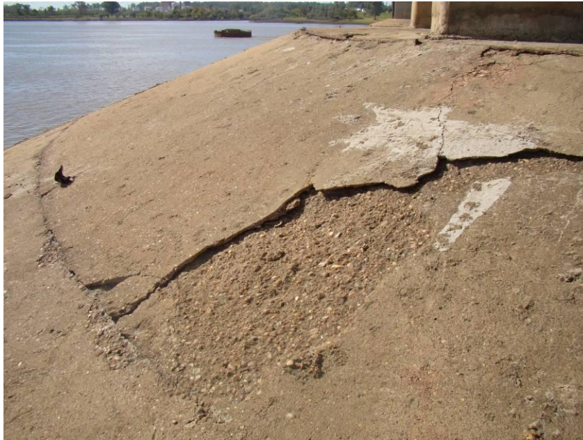
Figura 8. Pérdida de recubrimiento en cabezal de Pila 12.
