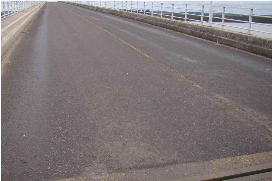
Figura 15. Desgaste de la señalización horizontal en el puente.
