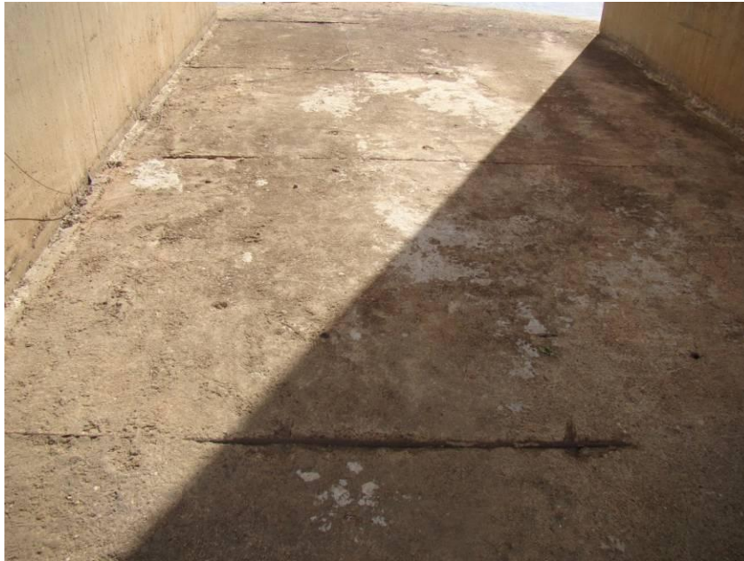
Figura 6. Vista de la armadura expuesta en el cabezal de la Pila 11.
