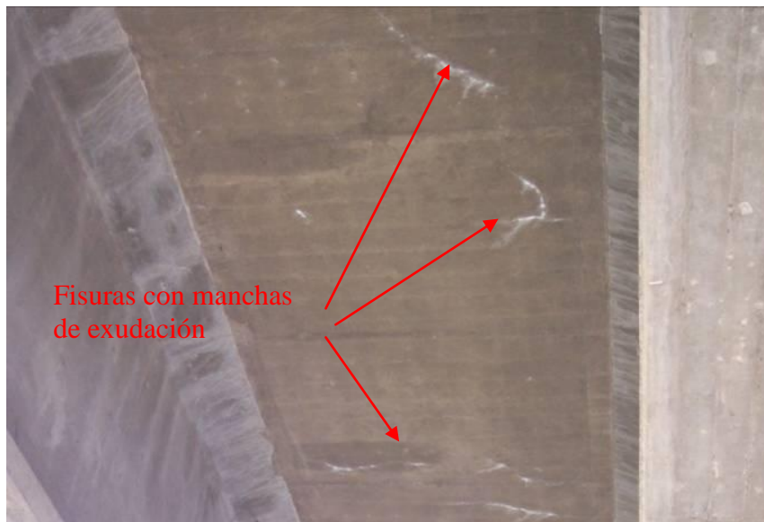
Figura 12. Detalle de fisuras con manchas de exudación de color blanco en la cara inferior de la losa (tramo 2).
