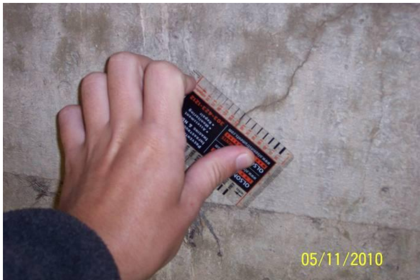
Figura 5. Detalle de una de las fisuras en el Estribo 1 (Lado Uruguayo).
